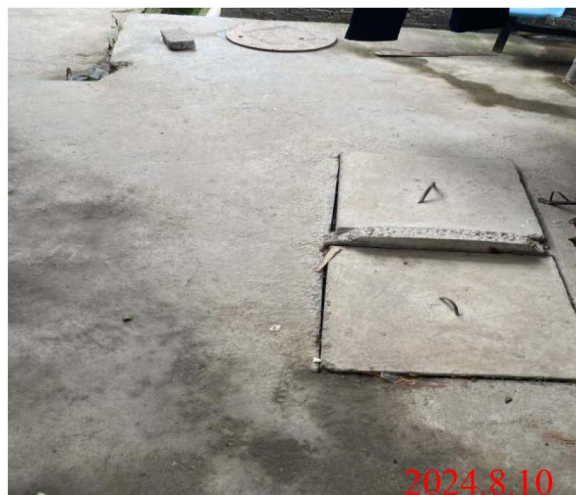
依托的化粪池
