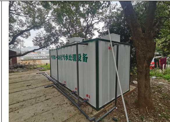
一体化污水处理设备及调节池
