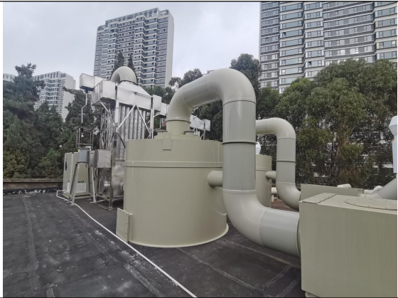
已安装废气治理设施（现状）
