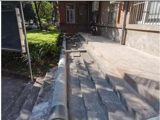
实验室废水管道（现状）
